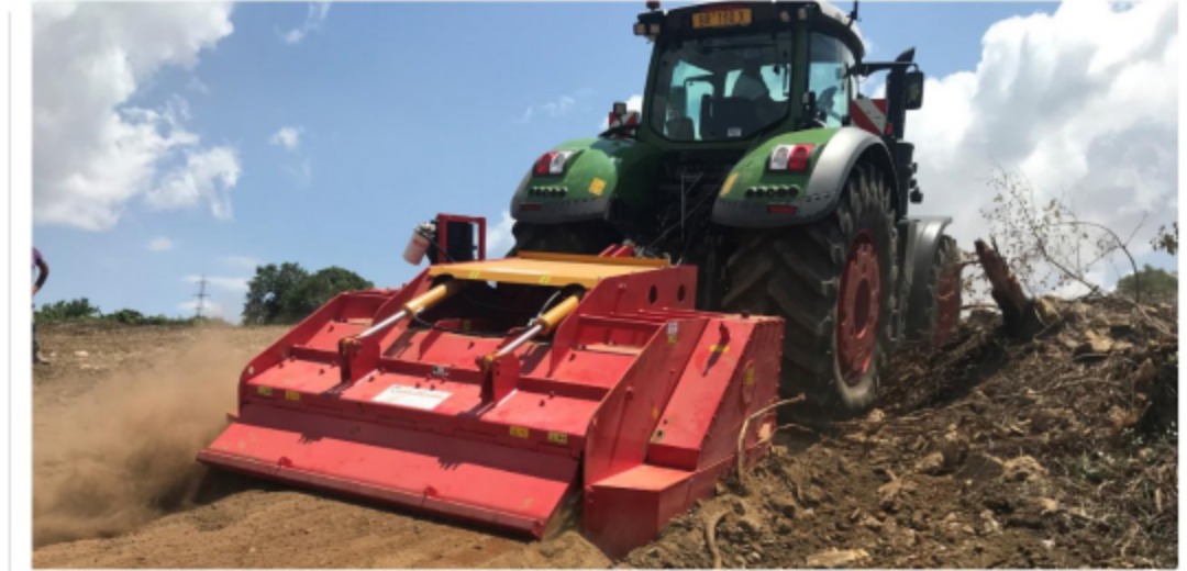
Ebenfalls als Generalimporteur regelt das Unternehmen federführend den Vertrieb von Crushing-Tech-Maschinen – jedoch für die komplette DACH-Region. Im Bild ist eine CRD 220T beim Zerkleinern von Steinen im Erdreich zu sehen. Über die hydraulisch verstellbare Heckklappe lässt sich der Zerkleinerungsgrad justieren.
